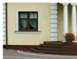
elewacja z dodatkiem minerału funkcyjnego dłużej zachowuje swoją estetyczny wygląd
